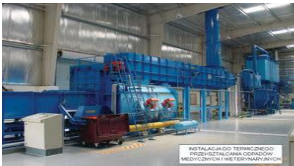
Ryc. 2 Instalacja termicznego przetwarzania odpadów medycznych i weterynaryjnych – polterm [1]
